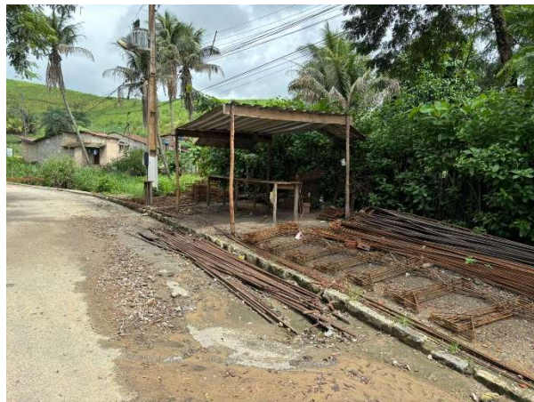
FOTO 7: DOBRA DO AÇO DAS LONGARINAS;
